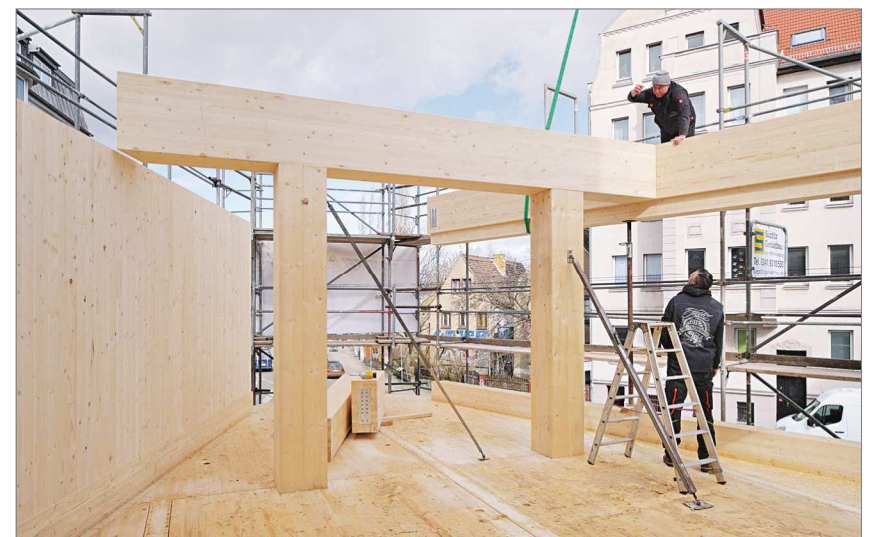
Im Bereich der Gebäudespitze dient ein (beidseitig auskragender) Träger auf zwei Stützen als Deckenaufleger. An den Trägerenden schließen die Randunterzüge der Außenwände an. Foto: Peter Eichler
